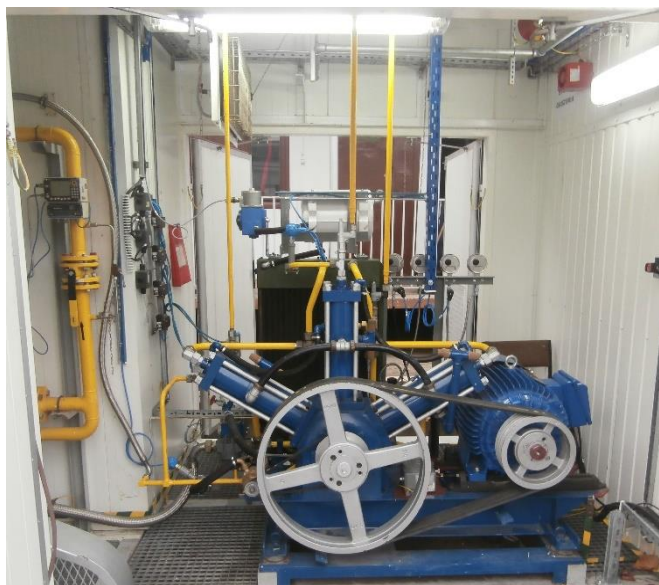
Fot. 3 Agregat sprężający gaz ziemny
